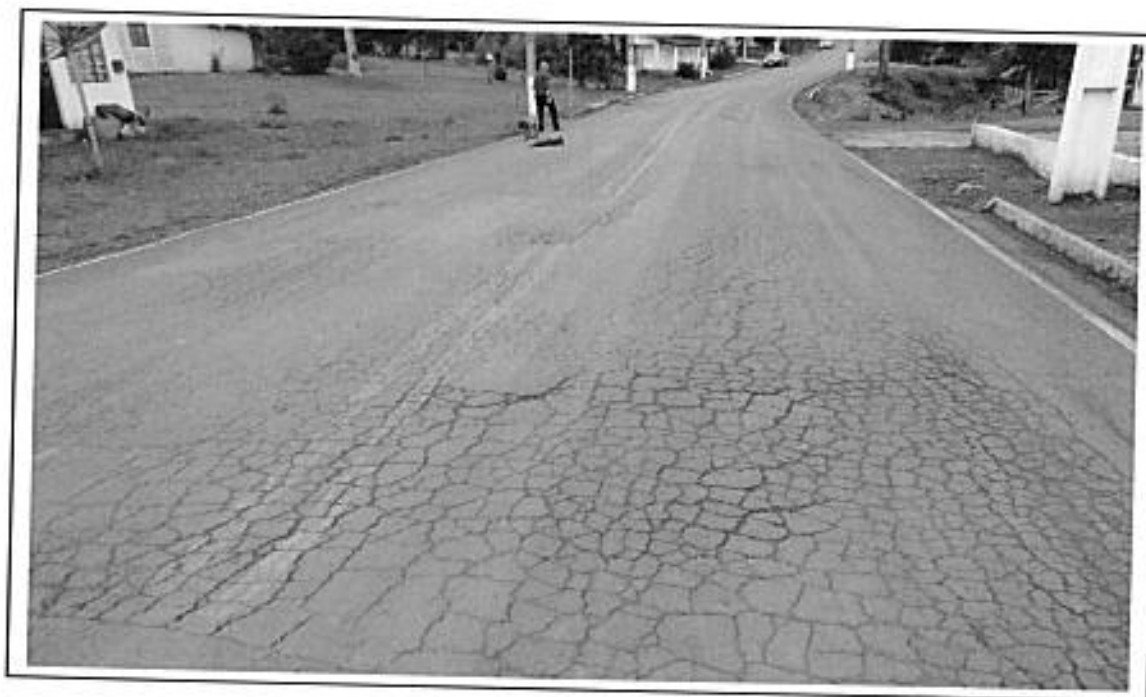
Ilustração 6: Trinca interligada tipo "Couro de Jacaré".
