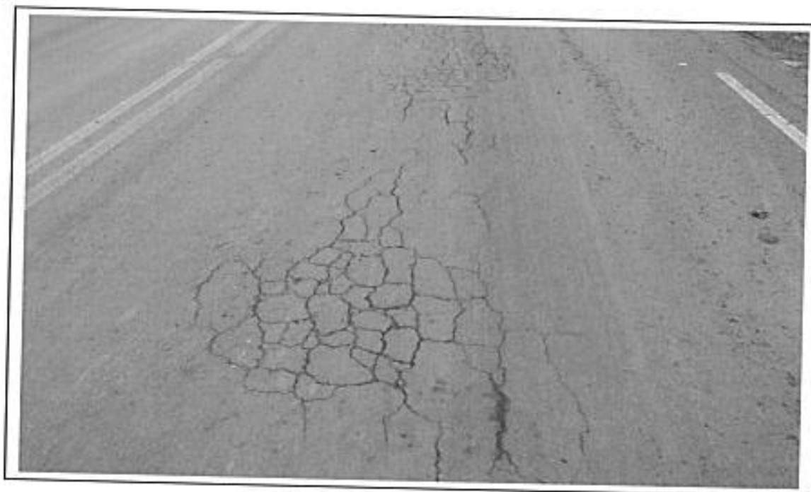
Ilustração 5: Trinca interligada tipo "Couro de Jacaré"
