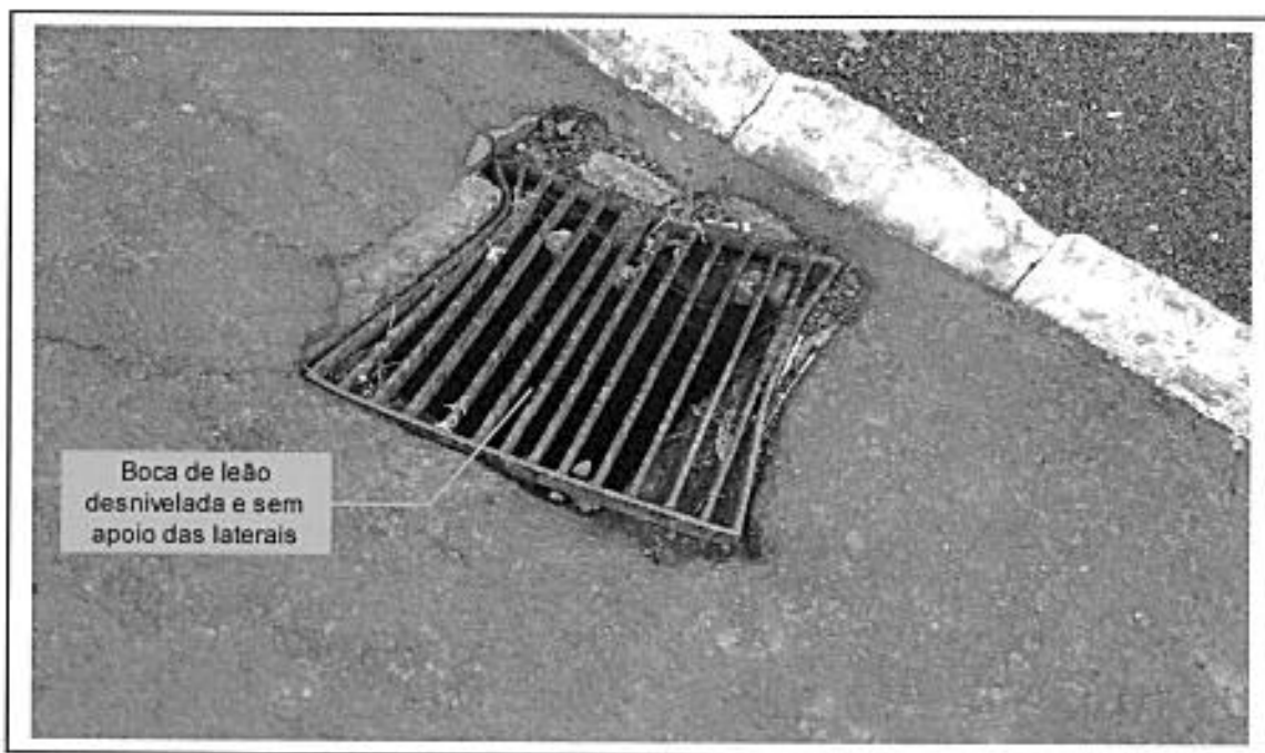
Ilustração 11: Rua 15 de Novembro, boca de leão.
