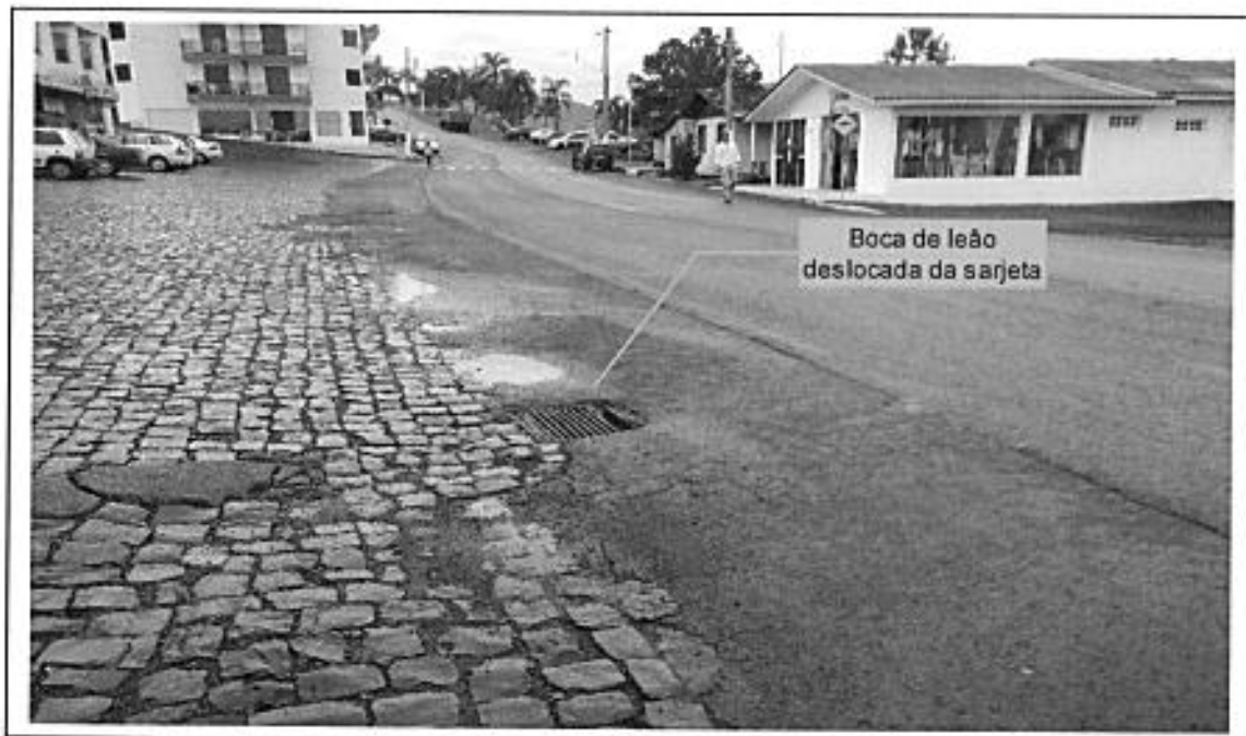
Ilustração 12: Rua 15 de Novembro, boca de leão.
