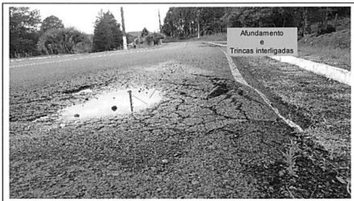
Ilustração 10: Rua 15 de Novembro, trinca interligada e depressão.
