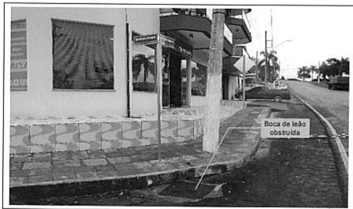
Ilustração 13: Rua 15 de Novembro, boca de leão tamponada.
